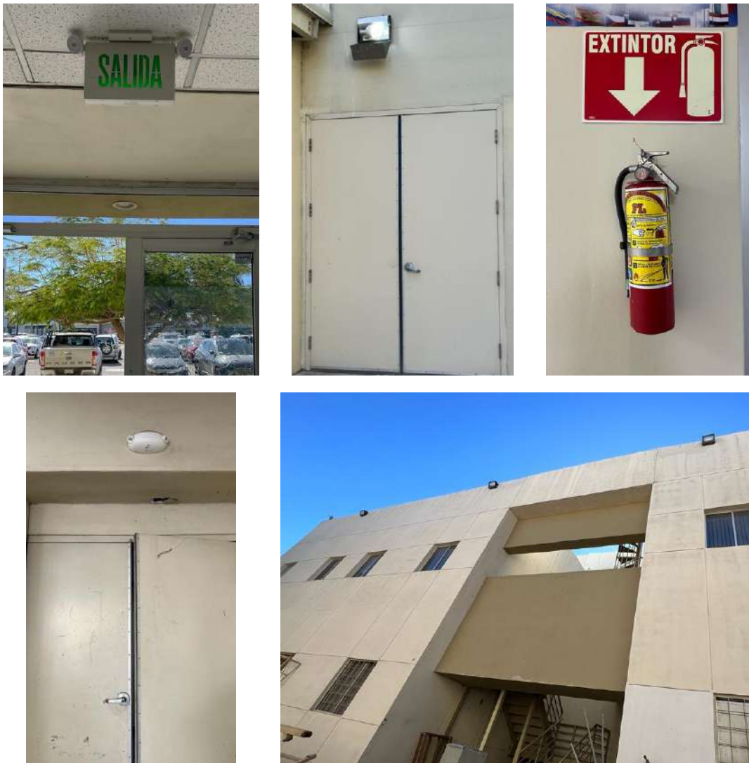
Figura 70. Instalaciones de luces de emergencia y señalizaciones.
